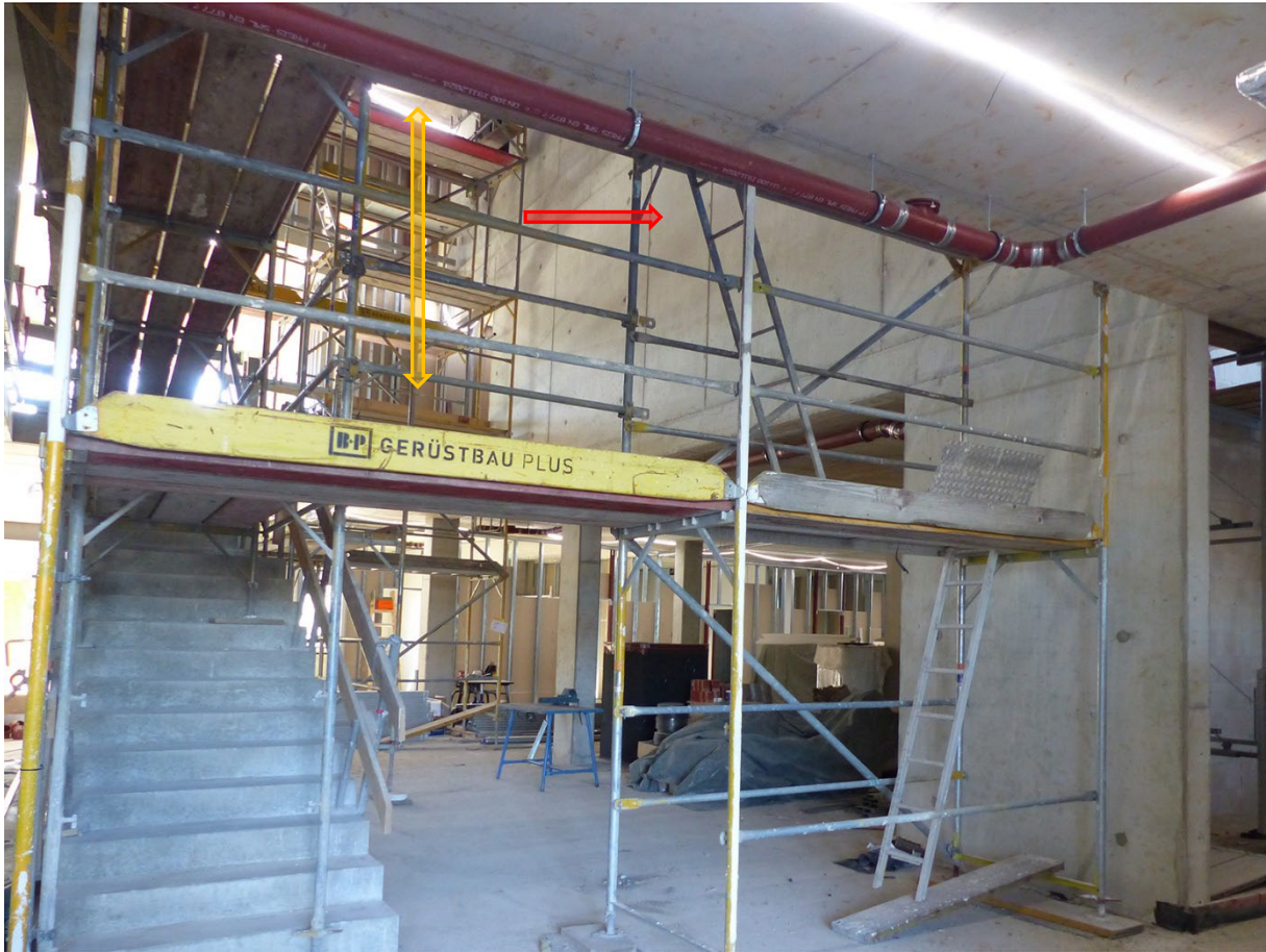
Erdgeschoss – Foyer mit Treppe und Blick zum geplanten Empfangsbereich mit Wartezone – darüber Betonwand 1. + 2. Obergeschoss – möglicher Kunststandort ① und Luftraum bis Oberlicht – möglicher Kunststandort ②
